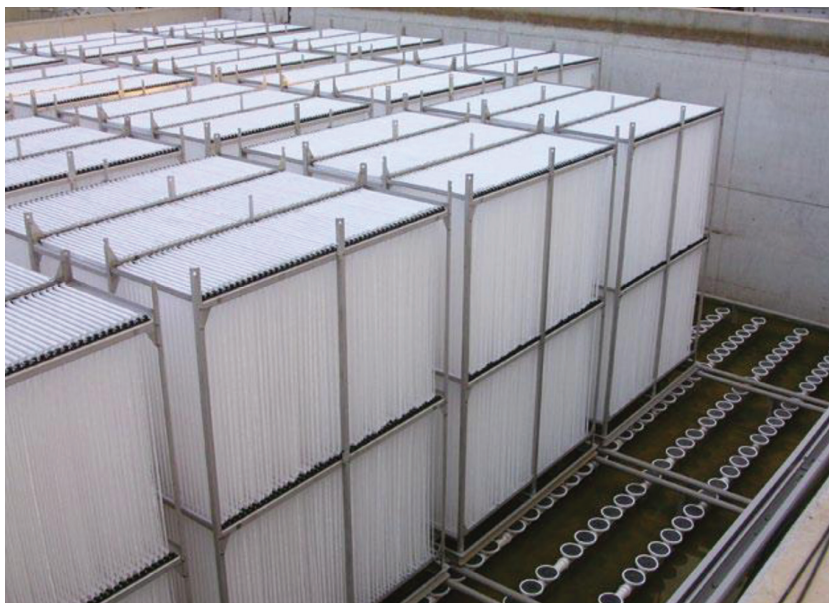
FIGURA 6. Bastidores Ifas en el reactor biológico.
