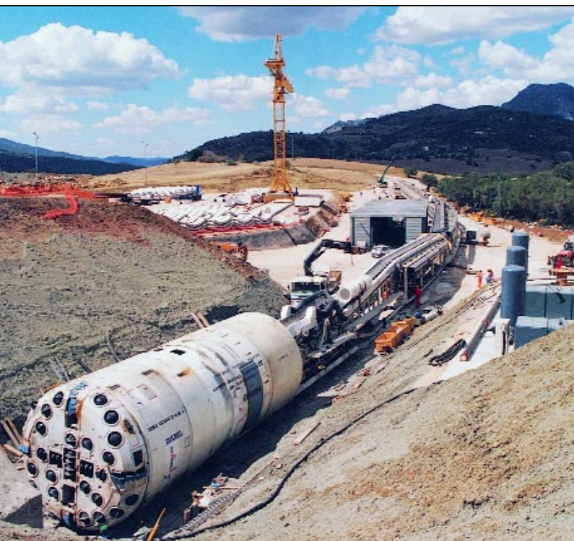
Tuneladora utilizada en las obras del trasvase, cuyo importe ha superado los 9.000 millones de pesetas.
