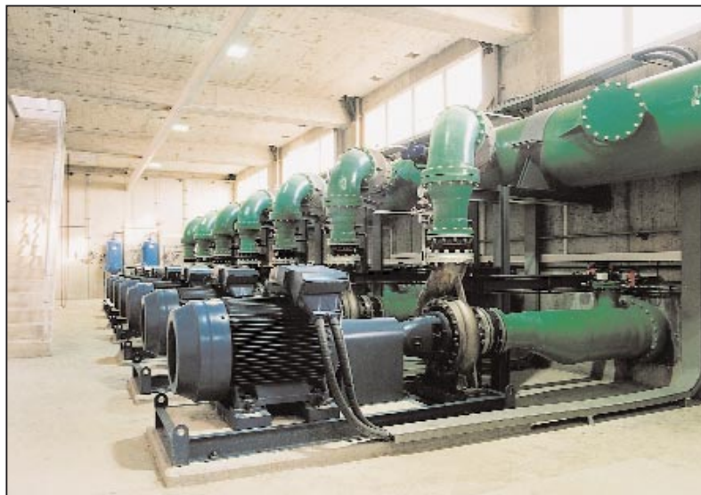
Sala de bombas de captación de agua de mar. Desaladora Bahía de Palma. Foto: Degrémont.
