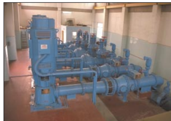
Estación elevadora Ebro Almozara. Foto cedida por el Ayuntamiento de Zaragoza.
