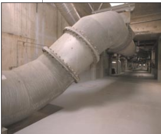
Aire de proceso de planta depuradora.
