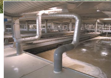
Desarenadores desengrasadores de la planta de aguas residuales de La Cartuja en Zaragoza. Foto cedida por el Ayuntamiento de Zaragoza.
