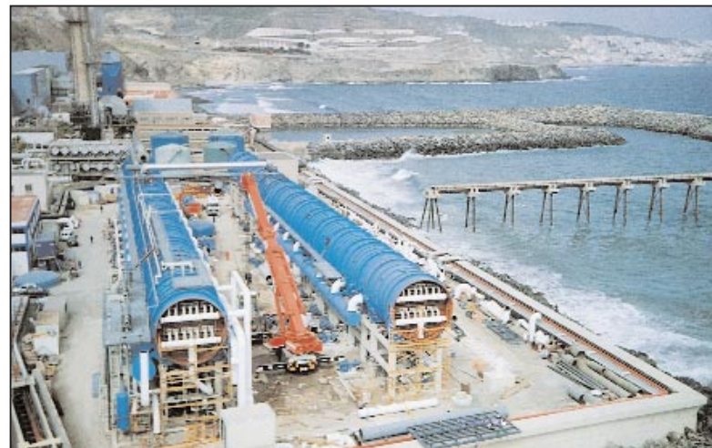
Planta desaladora de Las Palmas-Telde. Foto cedida por INIMA.
