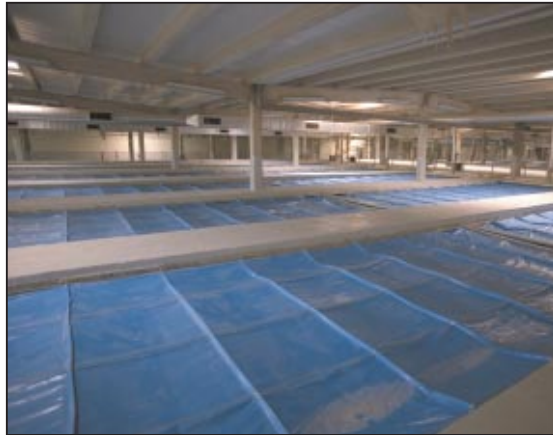
Decantadores primarios de planta potabilizadora. Foto: Ayuntamiento de Zaragoza.
