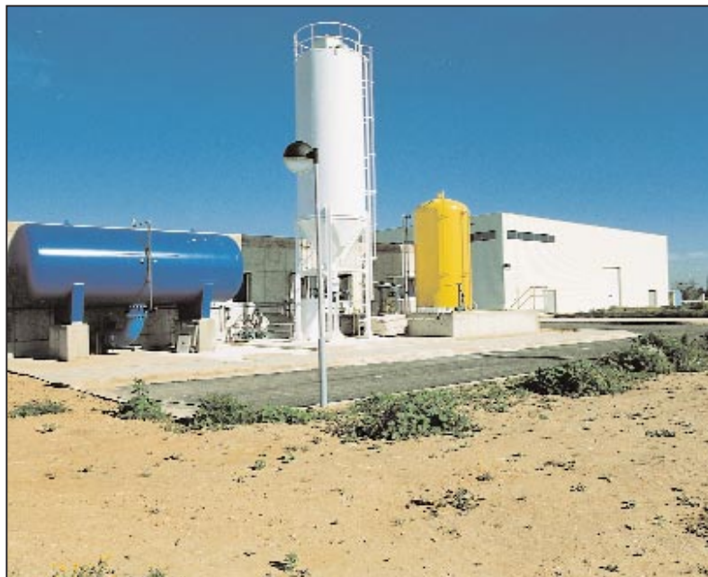
Postratamiento del agua. Desaladora Bahía de Palma. Foto cedida por Degrémont.
