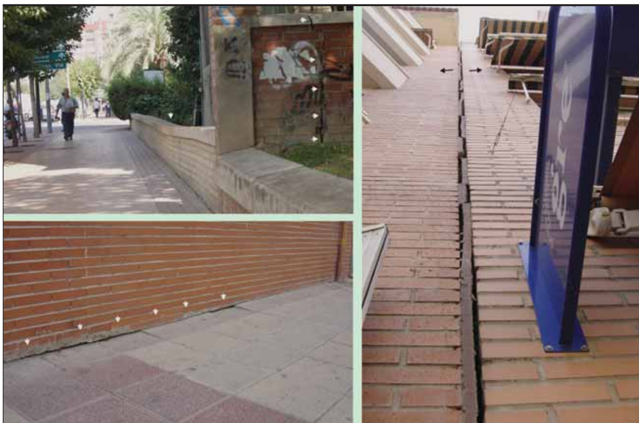
FIGURA 2. Efectos de la subsidencia observados en algunos elementos urbanos de la ciudad de Murcia (deformación de aceras y apertura de las juntas medianeras).
