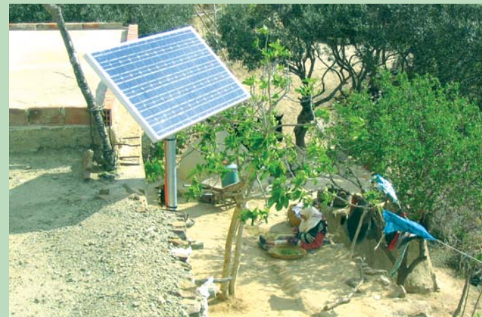
Fig. 3.2.- Panel solar instalado a través de un proyecto de cooperación para el desarrollo en la provincia de Chefchaouen (Marruecos).
