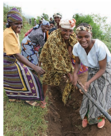
Una comunidad local instalando tuberías de agua para su poblado en Kinshere, Tanzania. Este proyecto llevará agua potable segura a la región por primera vez. Anteriormente, la gente tenía que recoger agua potable, a menudo no segura, desde riachuelos distantes y transportarla en cubos
